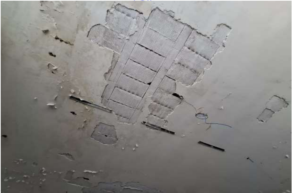
Cedimento intonaco per infiltrazioni meteoriche
